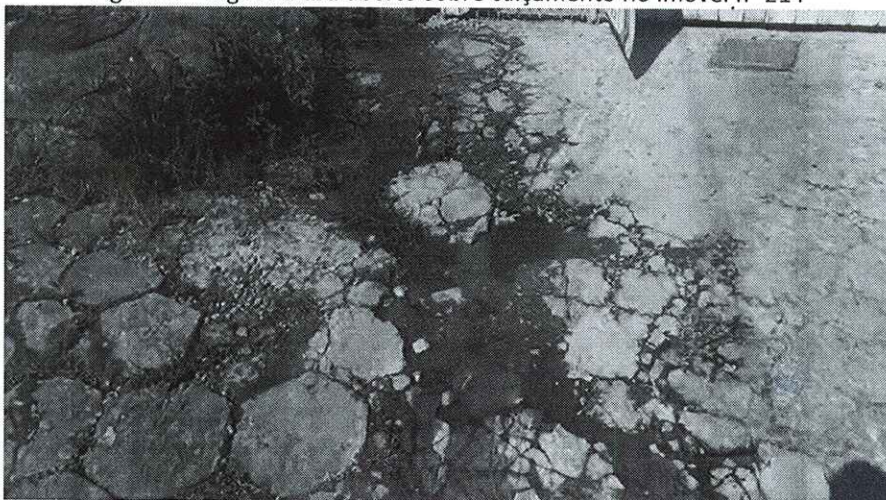
Figura 6 – Esgoto a céu aberto sobre calçamento no imóvel n° 214
