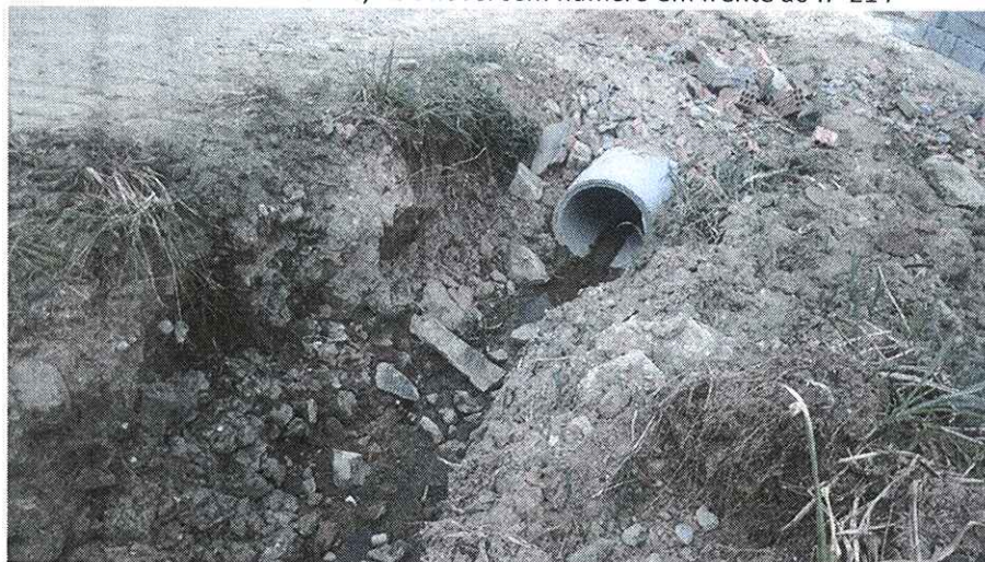
Figura 7 – Tubulação pluvial e vala improvisadas localizadas na Rua Leonor de Barros, no imóvel sem número em frente ao n° 214
